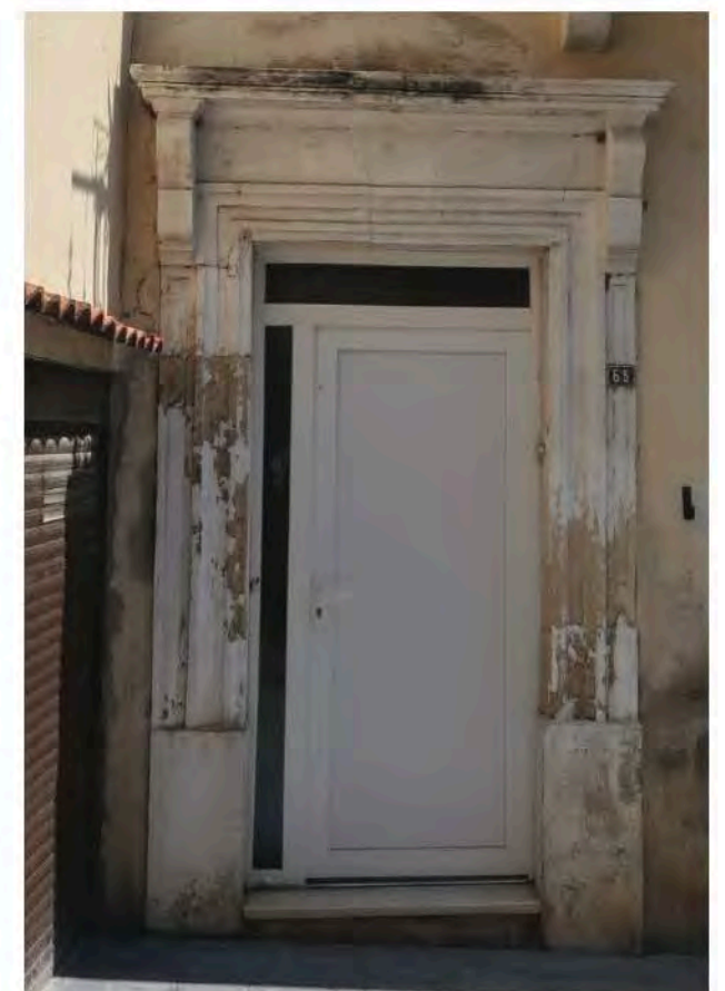
Châssis de porte PVC / alu inadaptée à l'encadrement
