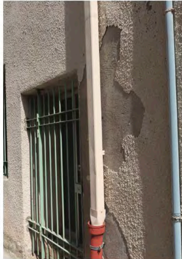
Décollement d'enduit préformulé sur base ciment portland (absence de perspiration), descente EP rectangulaire en alu
