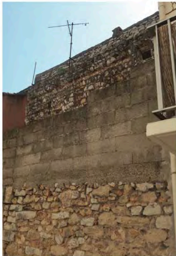
Rue des remparts, portion de rempart encore visible, arrachement
