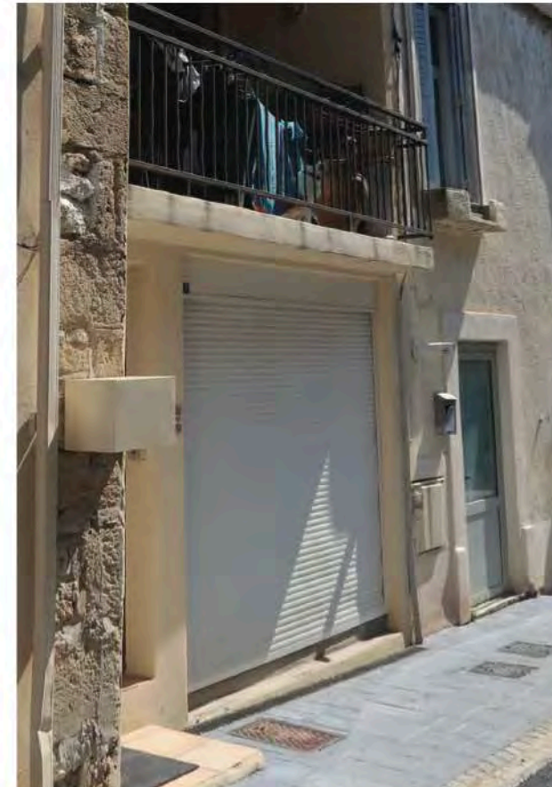
Dispositifs techniques en façade, volet roulant PVC, châssis de porte inadaptée à l'encadrement, BAL en saillance
