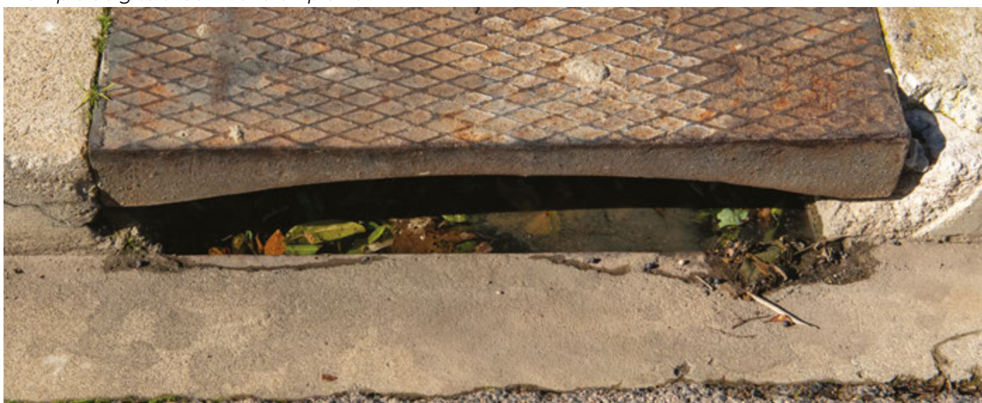
Exemple de gîte urbain : avaloir pluvial.
